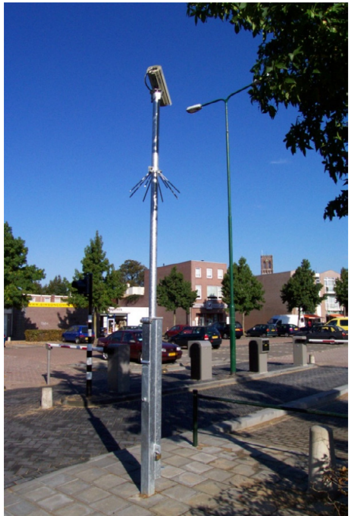
Abgesetzter Kamera-Kippmast mit Kletterschutz
